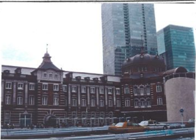
東京駅 南口1階部分と南口2階部分の工事の目的は、駅舎を解体して建て直すのではなく、1階部分の外壁を主要部分は保存し、焼失した部分を復原することだった。
